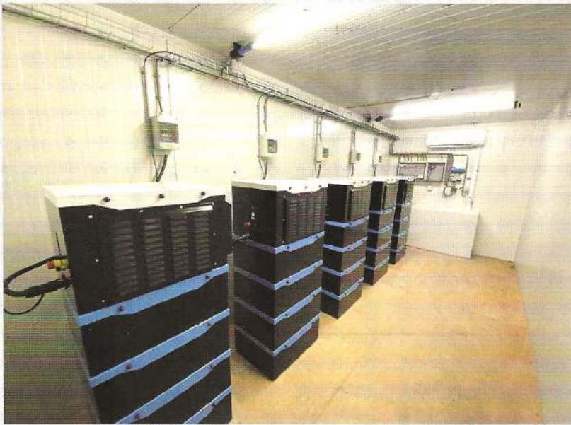
Batterij-opslag bij een agrarisch bedrijf maakt dynamisch omgaan met energie mogelijk.
