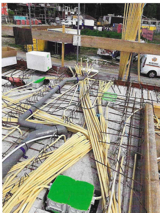
Steeds meer leidingwerk waarvoor ook plek moet zijn in de meterkast.
