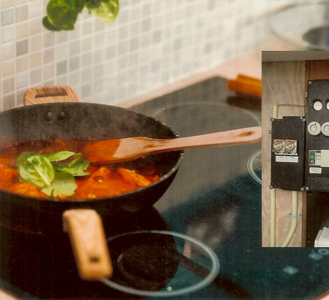
Deze groepverdelers is ongeschikt voor uitbreiding. Smeltzekeringen bij voorkeur vervangen door een automaat.
