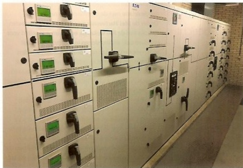
De hoofdverdeelkast kracht en licht (HKL) voor standspanning in de RAI.
