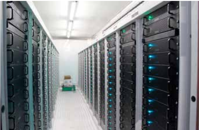
De accu-opslag is verbonden aan de transformator op het bedrijfsterrain en zo gekoppeld aan het stroomnet.
