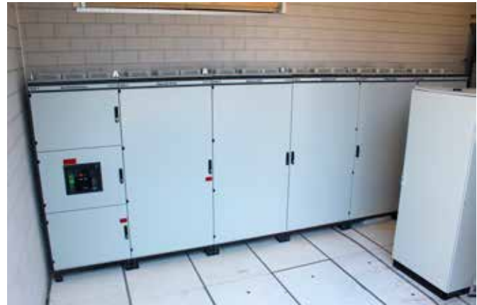
Groepkasten in de ruimte naast de accu-opslag. Door een systeem met vloerluiken zijn alle aansluitingen optimaal bereikbaar.
