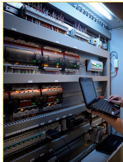
Afb. 2: Installatiewerk wordt complexer.
